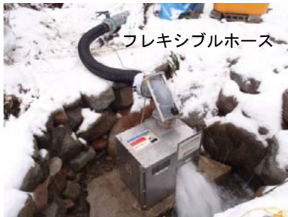
図5 3号機およびフレキシブルホース
