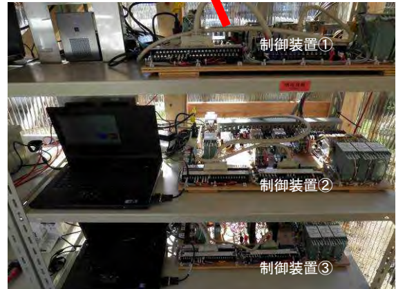
図8 自立運転システムの電力制御装置
