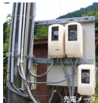
図 14 設置した売電メータ
