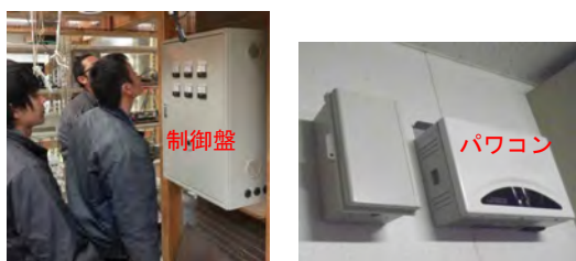
図12 制御盤およびパワコン
